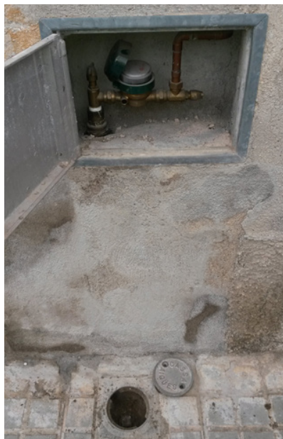
Exemple de comptador amb la clau de pas a terra
